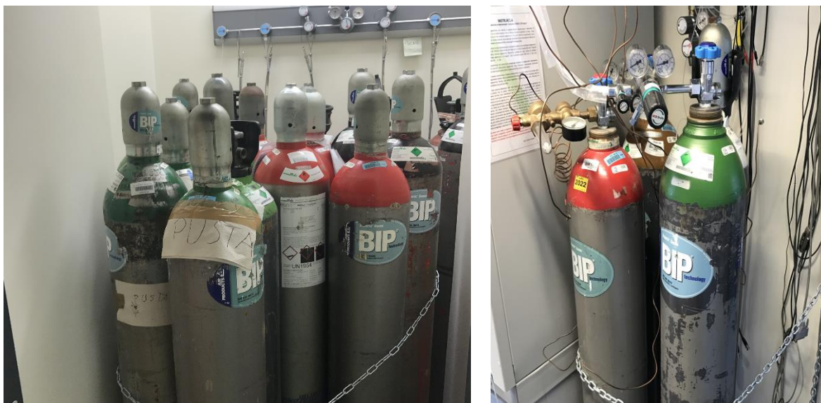
Przykładowe widoki magazynowania butli z gazami palnymi i wybuchowymi, które mogą tworzyć mieszaninę wybuchową.
